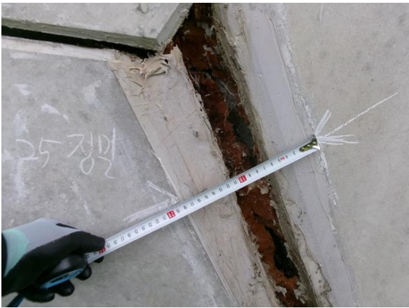
S11 2단 판넬 파손 및 이격(L=5.0m)
