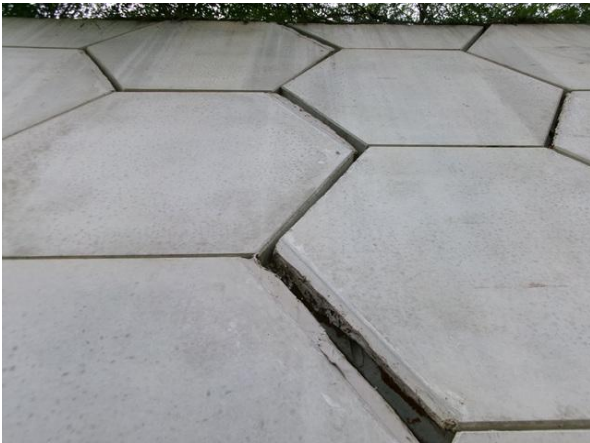
S11 2단 판넬 파손 및 이격(L=5.0m)
