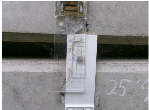
S11 2단 판넬 파손 및 이격(L=5.0m)
