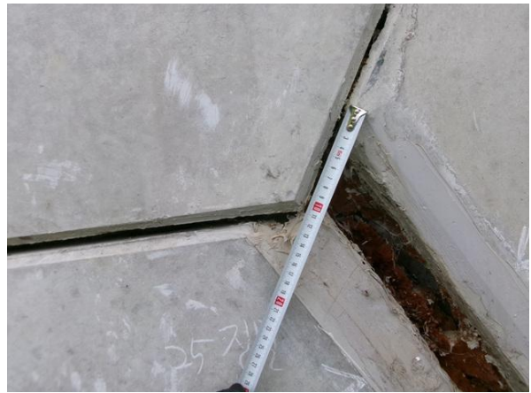
S11 2단 판넬 파손 및 이격(L=5.0m)
